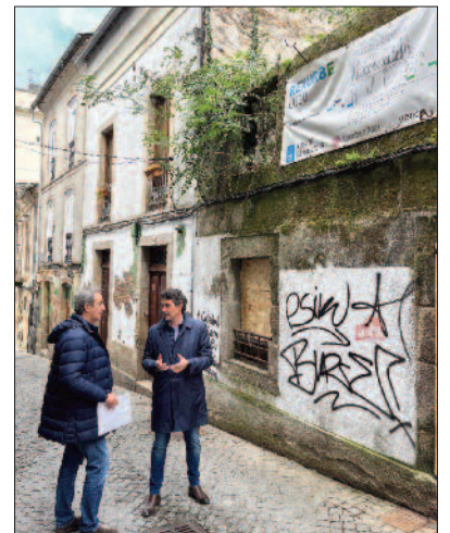
As casas están en moi mal estado de conservación.
