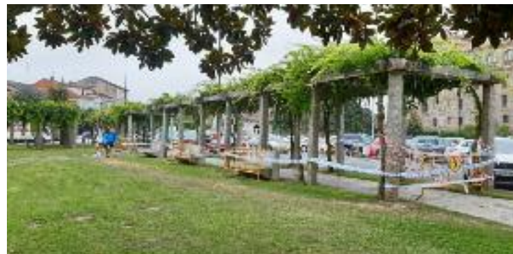
Pérgola danada no Parque dos Condes.
